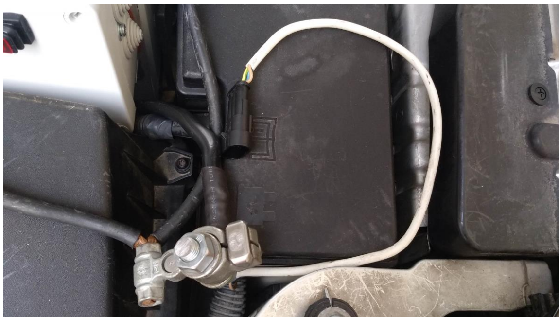
Εικόνα 6.10 : Καλώδιο μεταφοράς σημάτων θέσεων κλειδοδιακόπτη και ρελέ μίζας
