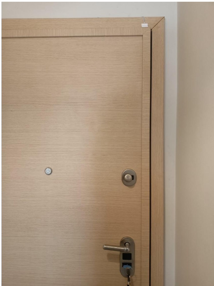
Εικόνα 4.12: Εγκατάσταση μαγνητικής επαφής στη θύρα
