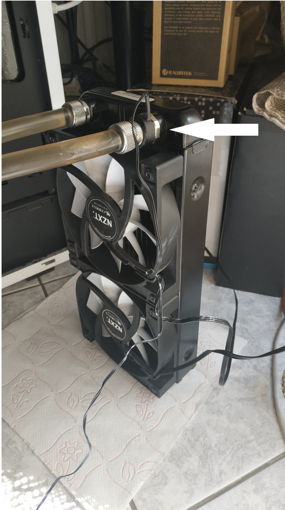
Σχήμα 3.2 Σημείο τοποθέτησης αισθητηρίου θερμοκρασίας στην υδρόψυξη.
