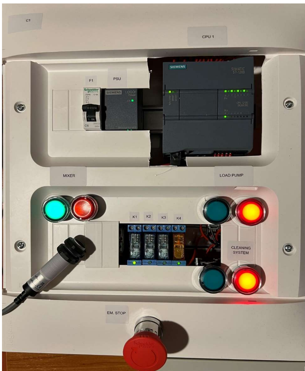
Εικόνα 2.18: Ο πίνακας αυτοματισμού.
