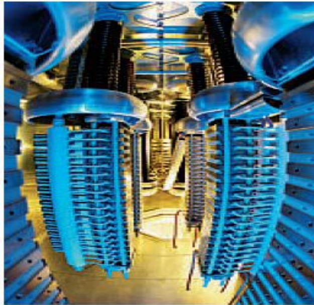
Εικόνα 10 : Μετατροπείς εναλλασσόμενης τάσης σε συνεχή με στοιχεία IGBT για υπόγεια μεταφορά ισχύος υπό υψηλή συνεχή τάση
