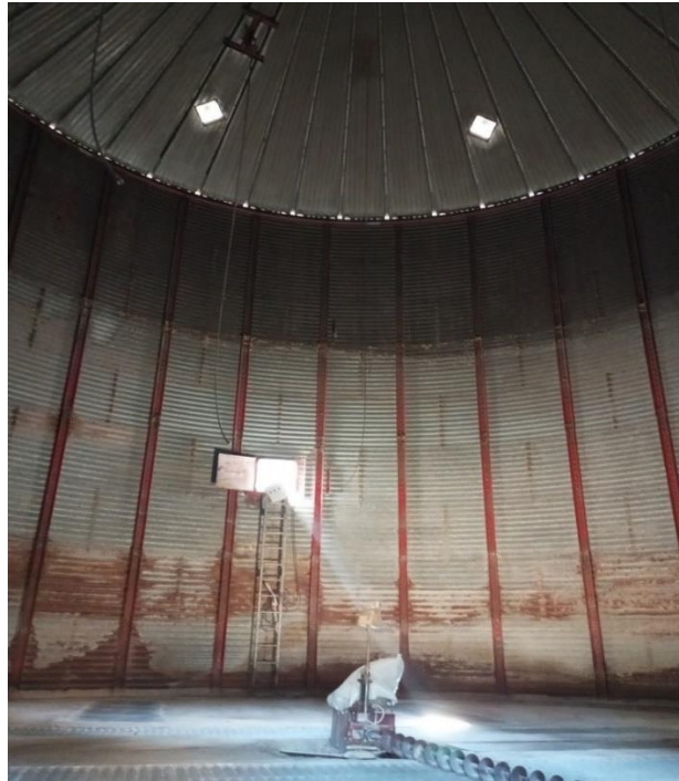
Εικόνα 4.4: Εσωτερικό ενός σιλό αποθήκευσης.
