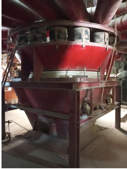
Εικόνα 4.11: Ζυγαριά 2 τόνων γραμμής παραγωγής με 4 load cells στο πάνω μέρος φαίνονται οι καταλήξεις των κοχλιών των σιλό πρώτων υλών.
