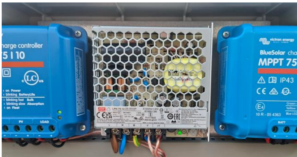
Σχήμα 4-11: Switching τροφοδοτικό 230 VAC σε 12 VDC για την τροφοδοσία των βοηθητικών κυκλωμάτων
