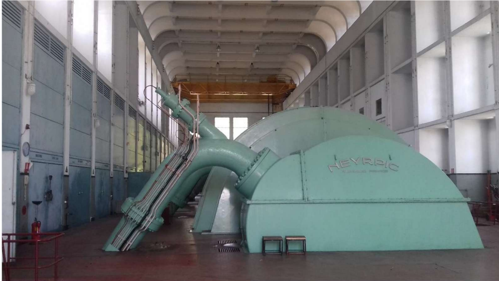
Εικόνα 3.2. Υδροστροβίλοι και γεννήτριες μέσα στο σταθμό[75]
