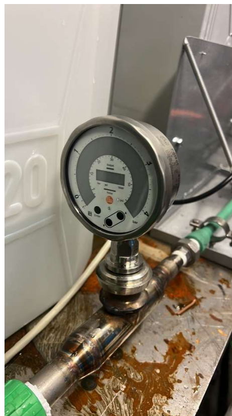
Εικόνα 4.7. Μανόμετρο ένδειξης πίεσης κυκλώματος.
