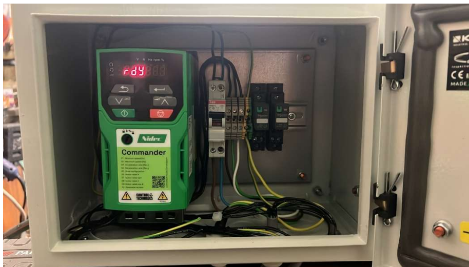
Εικόνα 4.1. Ηλεκτρικός πίνακας με μετατροπέα συχνότητας (inverter) για τον έλεγχο της αντλίας παροχής του υδραυλικού κυκλώματος.
