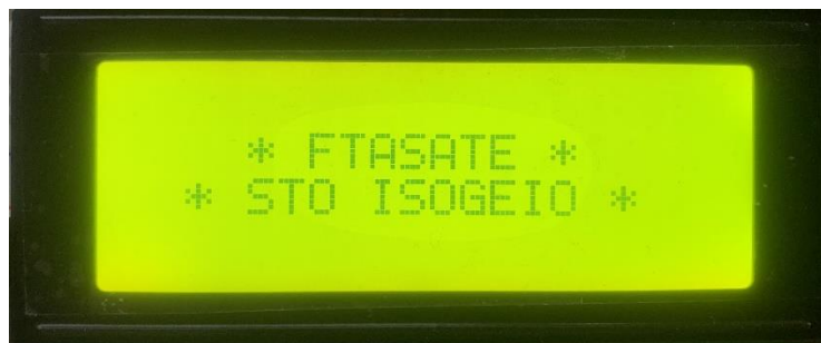
Εικόνα 31. Οθόνη για την άφιξη του θαλάμου στο 'Ισόγειο'.
