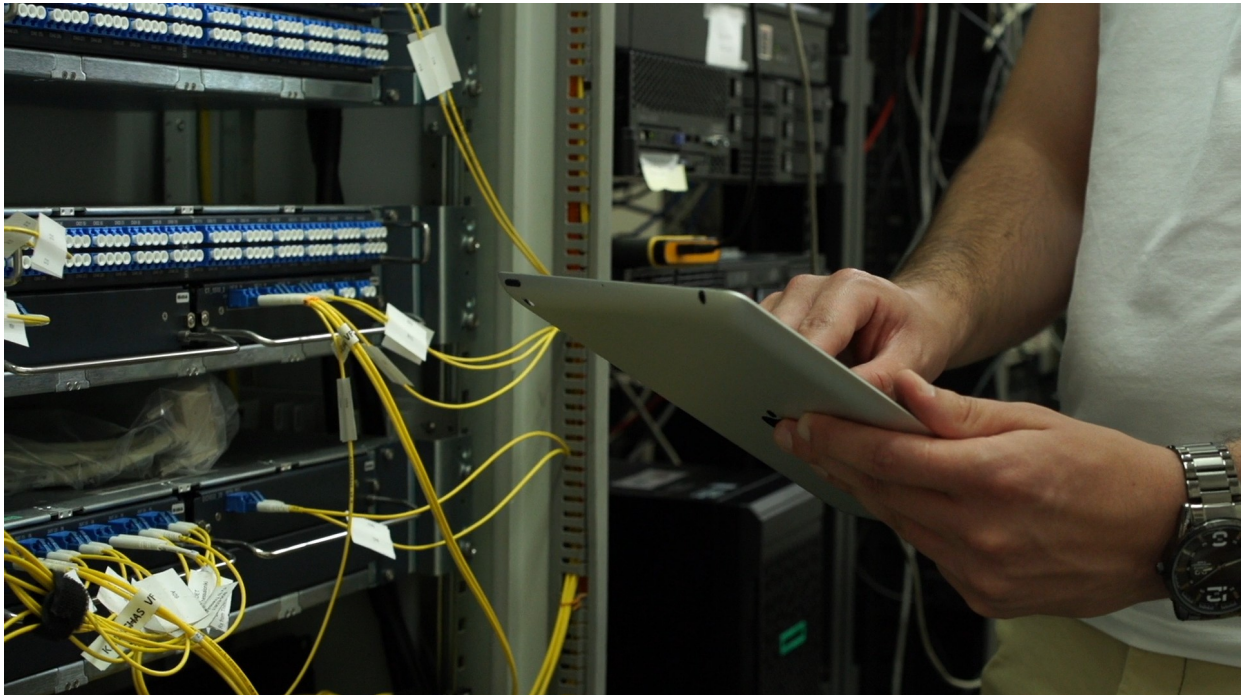
Εικόνα 19: Κέντρο δικτύων ΔΙΠΑΕ, Σίνδος
