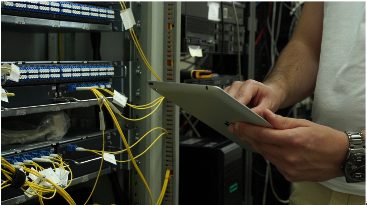
Εικόνα 32: Λήψη στο χώρο του κέντρου δικτύων, λήψη 1
