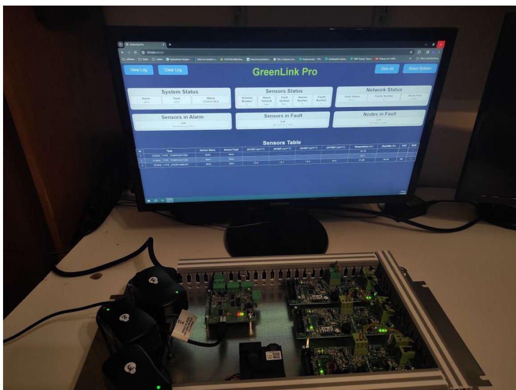
Εικόνα 90 - Ζωντανή απεικόνιση του συστήματος στο GreenLink Pro
