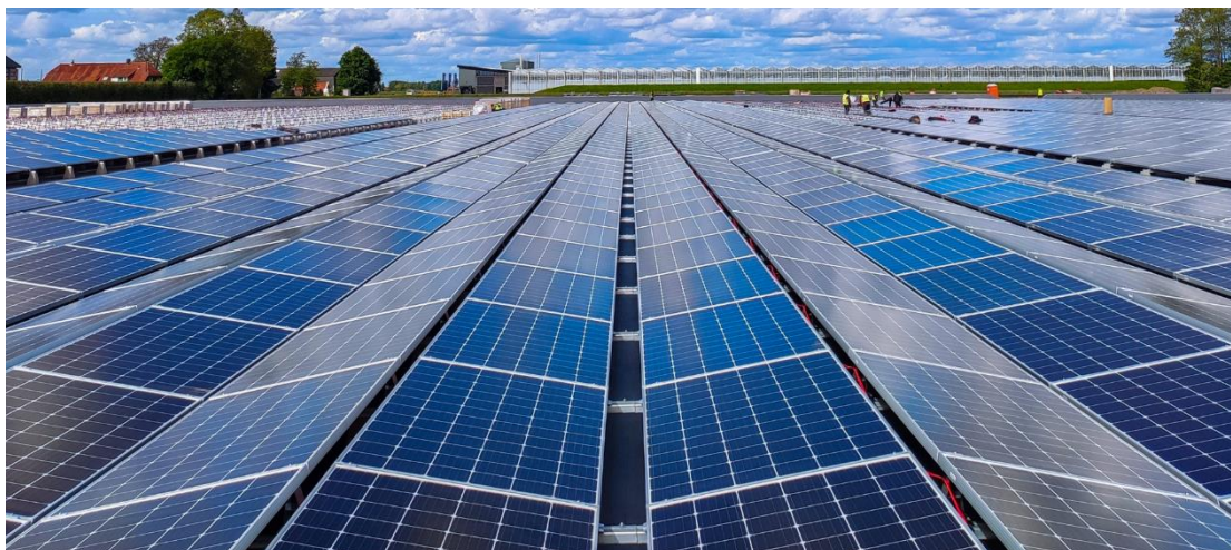
Σχήμα 2.1: Συστοιχία φωτοβολταϊκών πλαισίων για ανανεώσιμη παραγωγή ηλεκτρισμού
