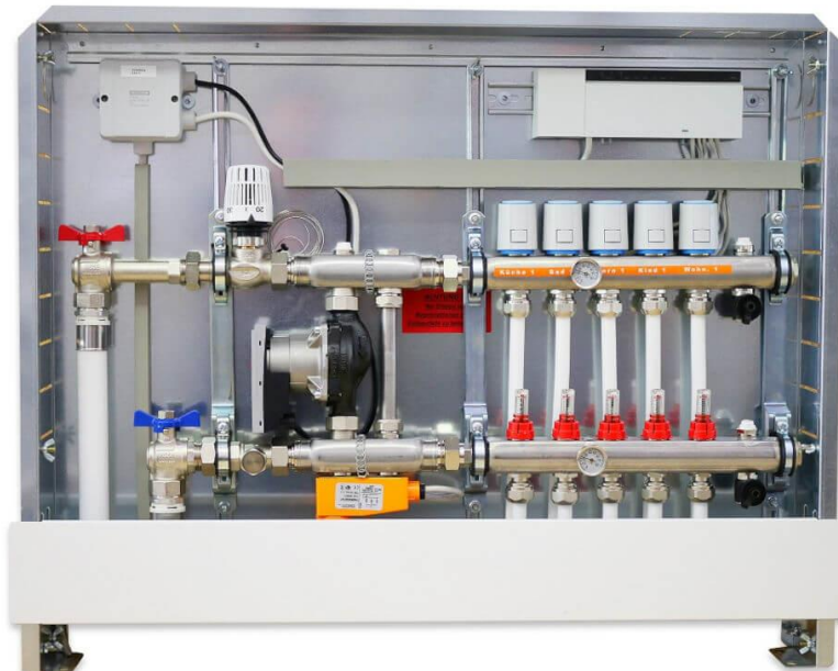
Εικόνα 3.33 : Σταθμός διανομής νερού θέρμανσης
