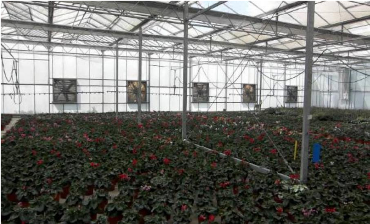
Εικόνα 11: Σύστημα εξαερισμού σε θερμοκήπιο
