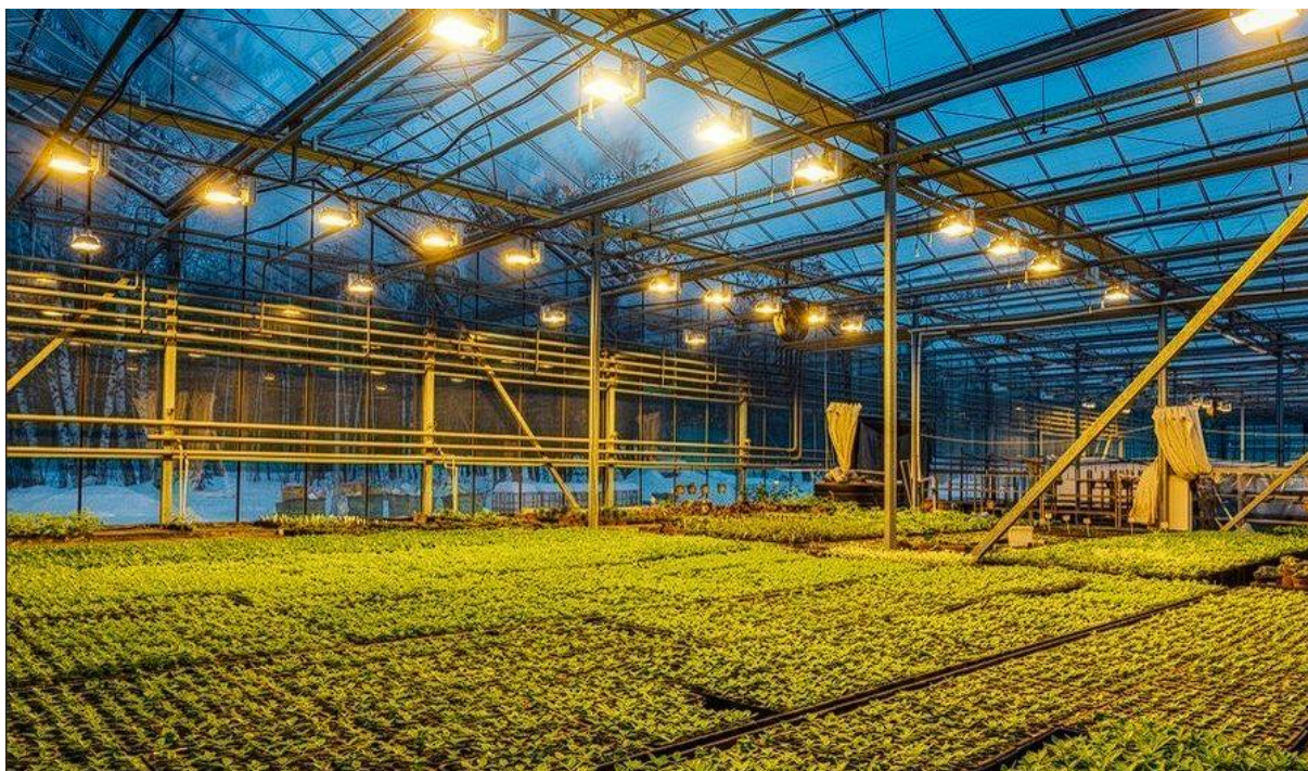
Εικόνα 12: Σύστημα φωτισμού σε θερμοκήπιο
