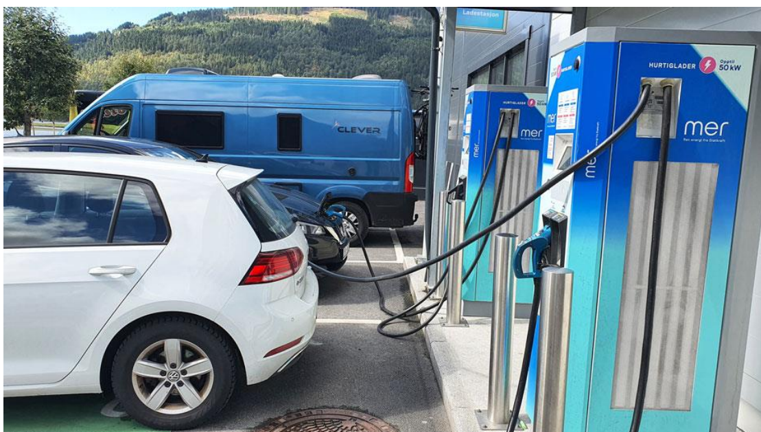
Εικόνα 3.5: Σταθμός φόρτισης ηλεκτρικών οχημάτων
