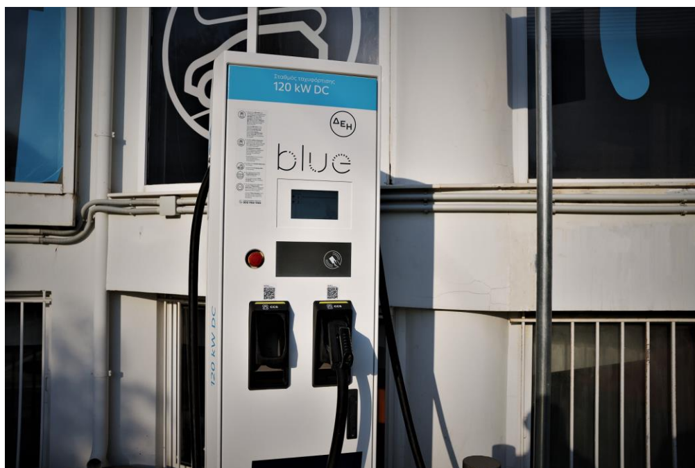
Εικόνα 3.3: Σταθμός φόρτισης ηλεκτρικών οχημάτων
