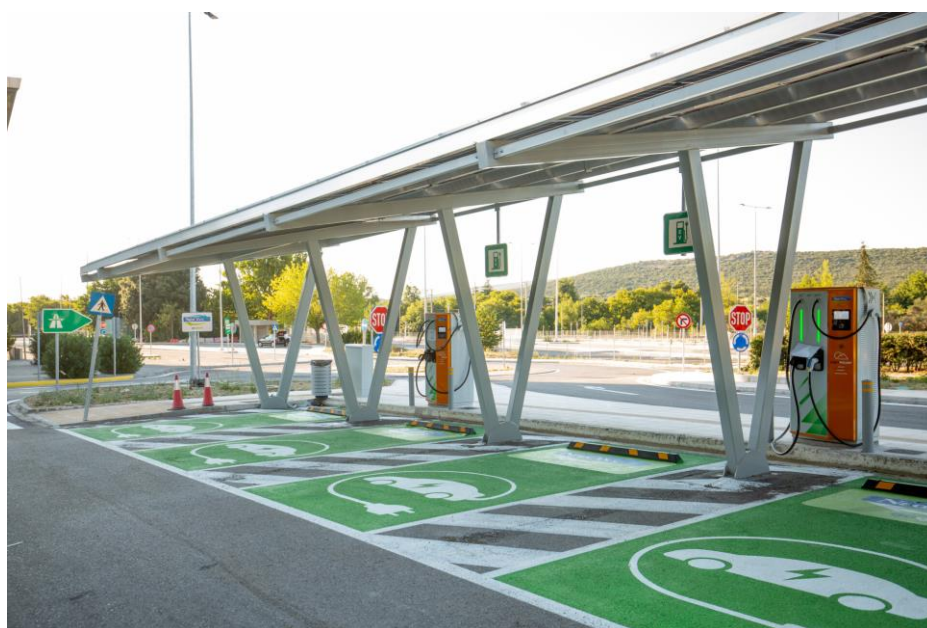
Εικόνα 3.4: Σταθμός φόρτισης ηλεκτρικών οχημάτων
