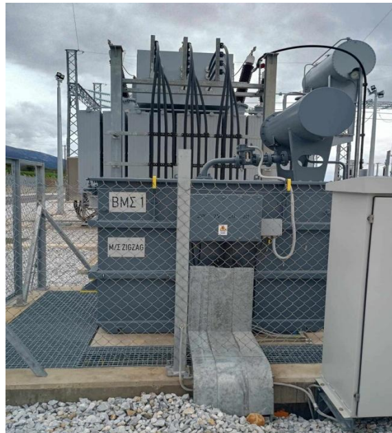
Σχήμα 1.6 Μ/Σ εσωτερικής υπηρεσίας
