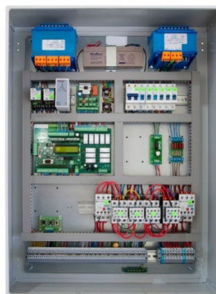
Εικόνα 2.2 Σύγχρονος πίνακας ελέγχου για υδραυλικούς ανελκυστήρες
