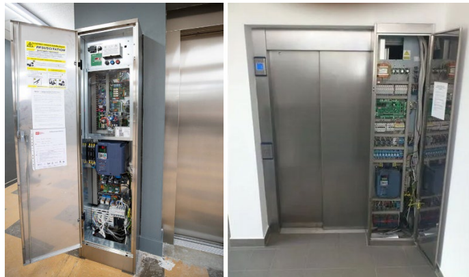
Εικόνα 2.6 Σύγχρονος πίνακας ελέγχου για ηλεκτροκίνητους ανελκυστήρες MRL
