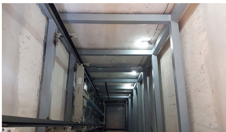
Εικόνα 2.7 Φρεάτιο ηλεκτροκίνητου ανελκυστήρα έλξεως
