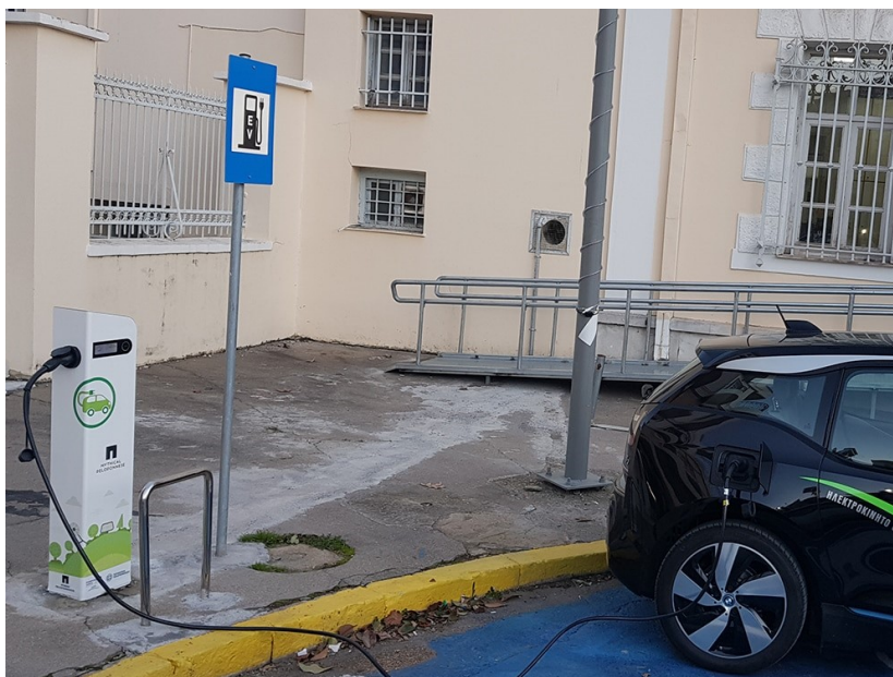
Εικόνα 6.2: Δημόσιος σταθμός φόρτισης ηλεκτρικών αυτοκινήτων στην περιφέρεια Πελοποννήσου [152]
