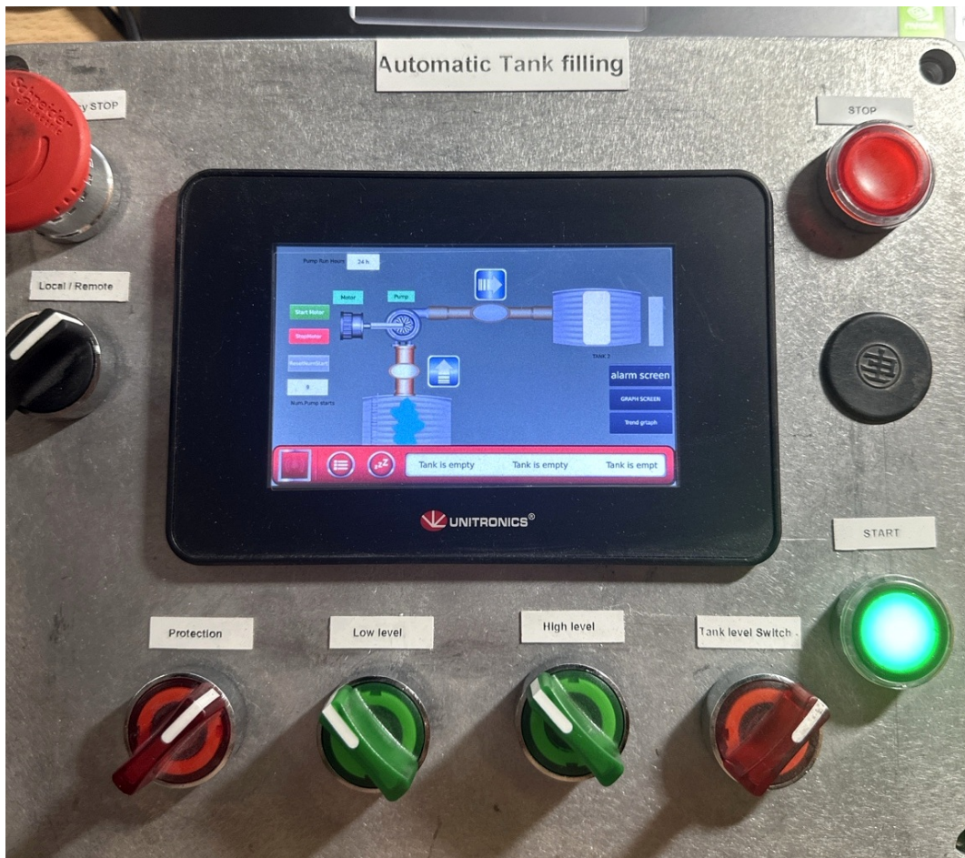
Σχήμα 4.1: Τελική πειραματική κατασκευή του συστήματος αυτόματης πλήρωσης δεξαμενής με HMI και φυσικά χειριστήρια.
