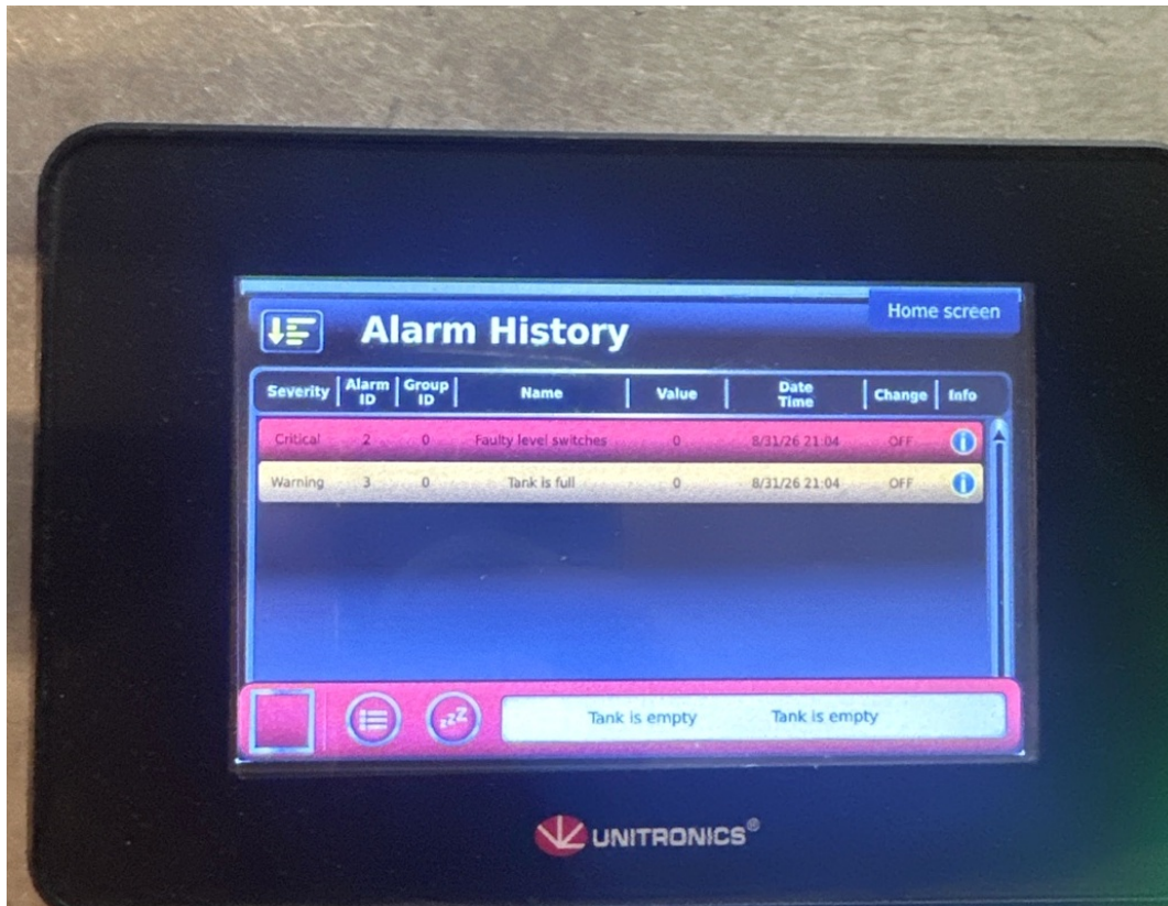
Σχήμα 4.8: Ιστορικό συναγερμών του συστήματος μέσω της λειτουργίας Alarm History του HMI.
