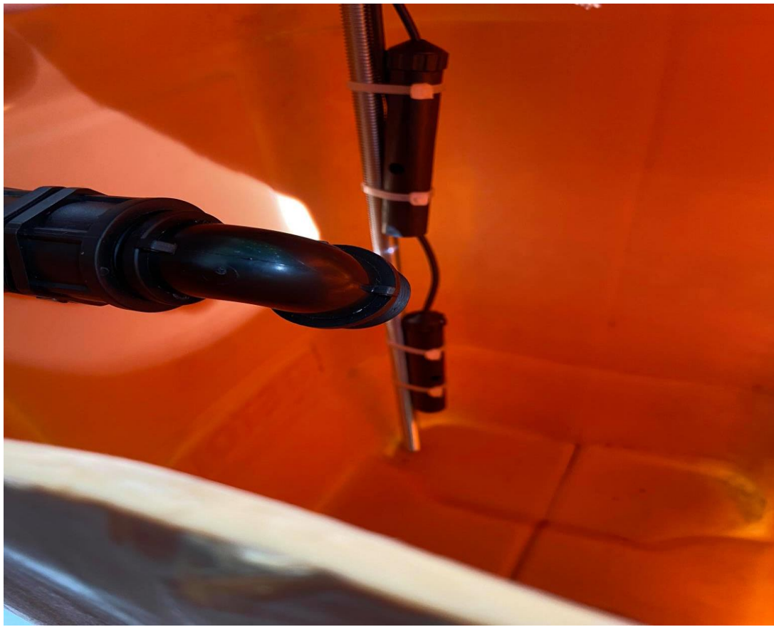
Εικόνα 6.4: Τα αισθητήρια τοποθετημένα στη δεξαμενή
