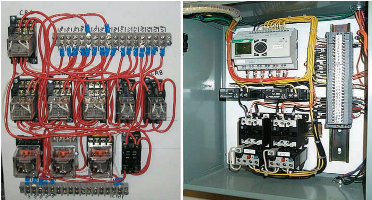
(α) Πίνακας αυτοματισμού με τη λογική ρελέ (β) Πίνακας αυτοματισμού βασισμένος στο PLC
