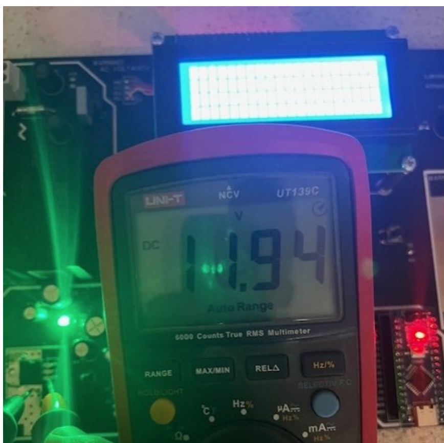
Εικόνα 5.8: Μέτρηση τάσης 12V
