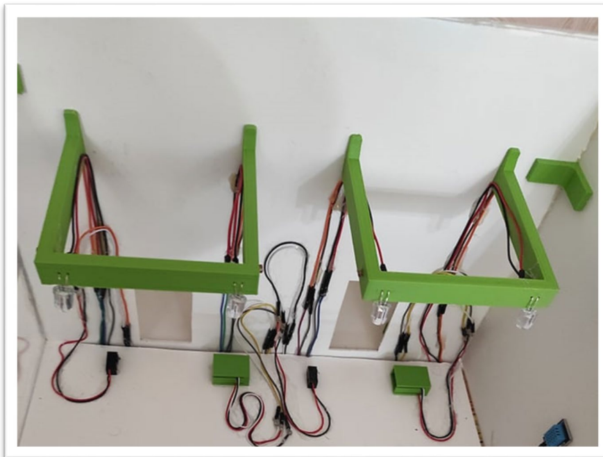
Εικόνα 4.66: Υλοποίηση συστήματος LED στον κεντρικό χώρο
