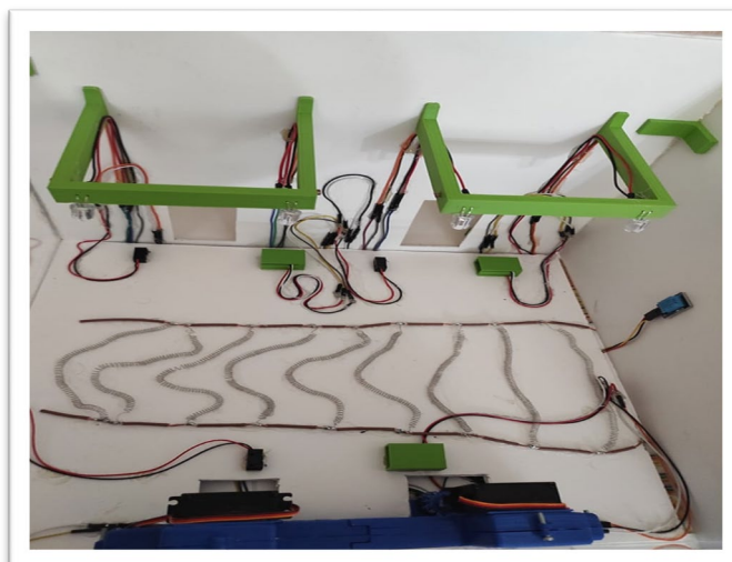
Εικόνα 4.54: Ηλεκτρολογική εγκατάσταση κεντρικού δωματίου
