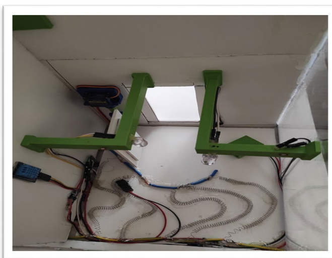
Εικόνα 4.55: Ηλεκτρολογική εγκατάσταση δωματίου1
