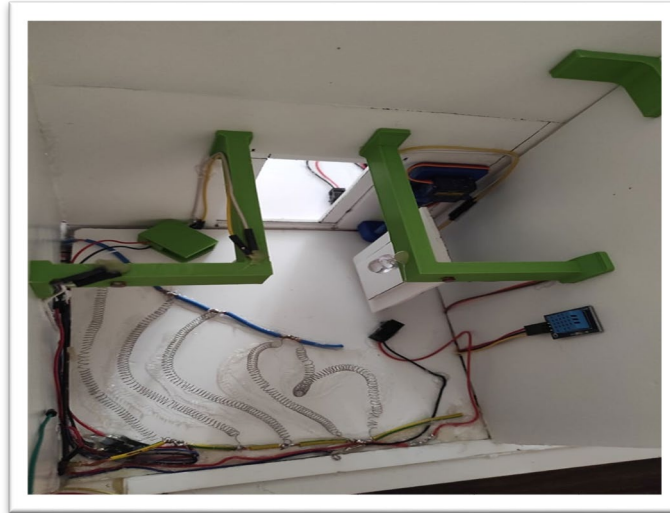
Εικόνα 4.56: Ηλεκτρολογική εγκατάσταση δωματίου2
