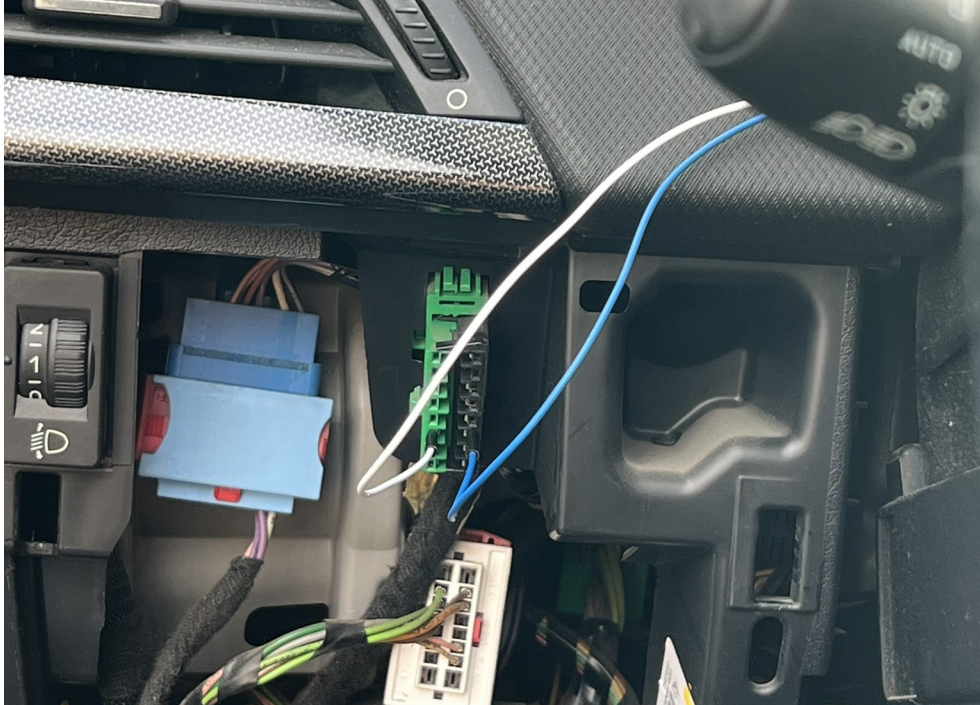
Σχήμα 5.4: Σύνδεση ακροδεκτών του CAN module MCP2515 στις θύρες CAN-H (καλώδιο μπλε) και CAN-L (λευκό καλώδιο).
