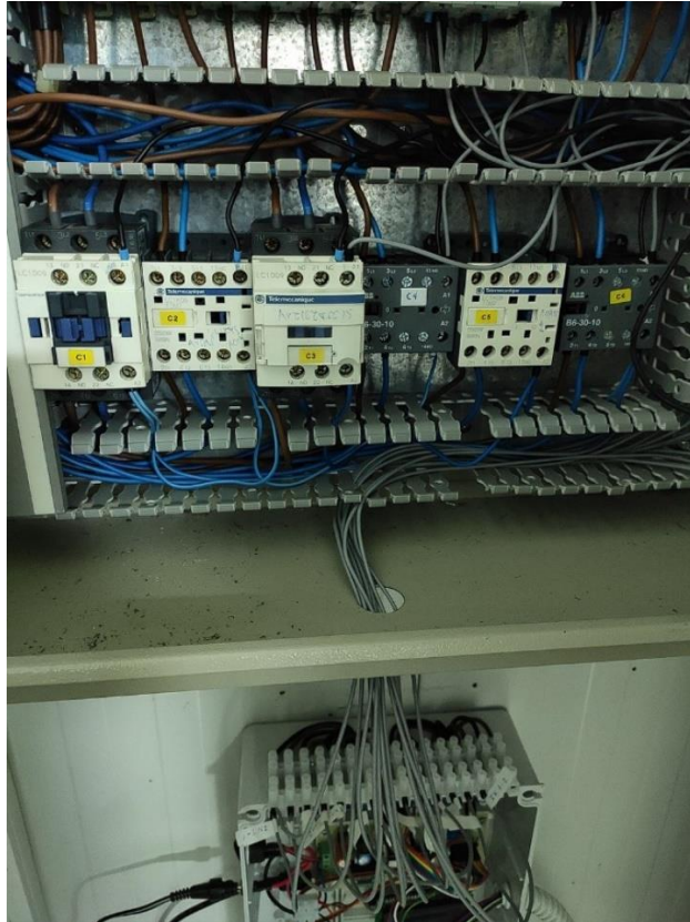
Εικόνα 4.15: Σύνδεση πλακέτας ρελέ με τον ηλεκτρολογικό πίνακα.
