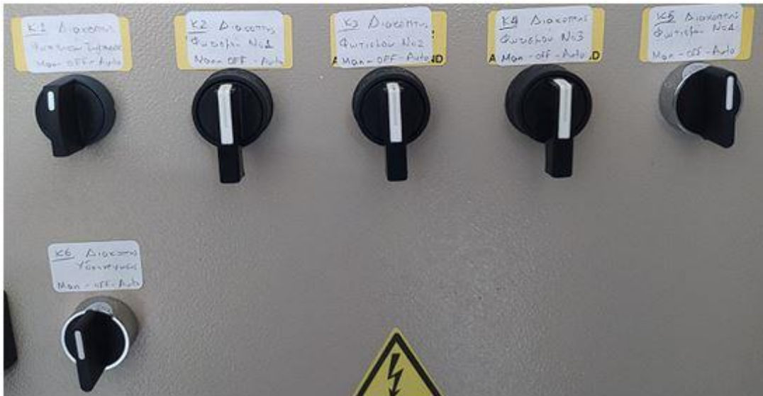
Εικόνα 4.4: Περιστροφικοί Διακόπτες Ισχύος – Μετά τις αλλαγές.
