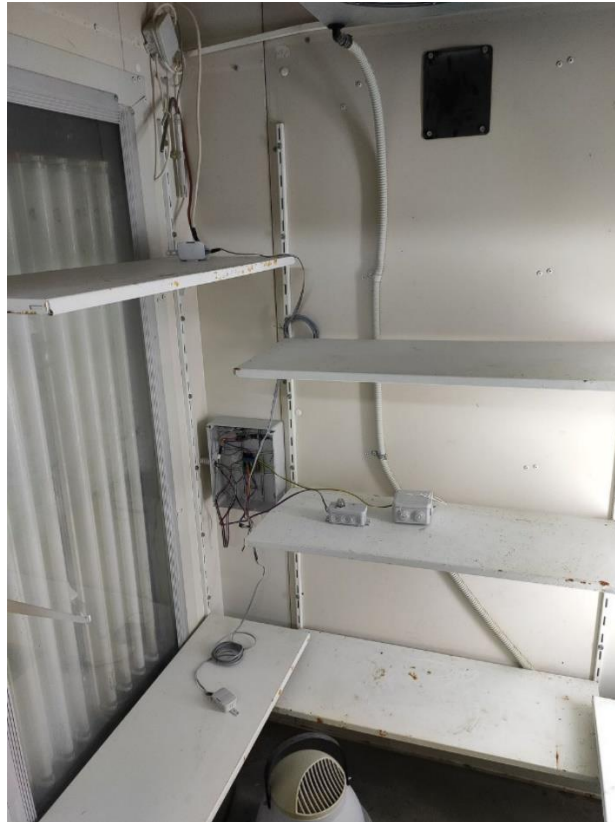
Εικόνα 4.18: Τοποθέτηση αισθητηρίων μέσα στον θάλαμο.
