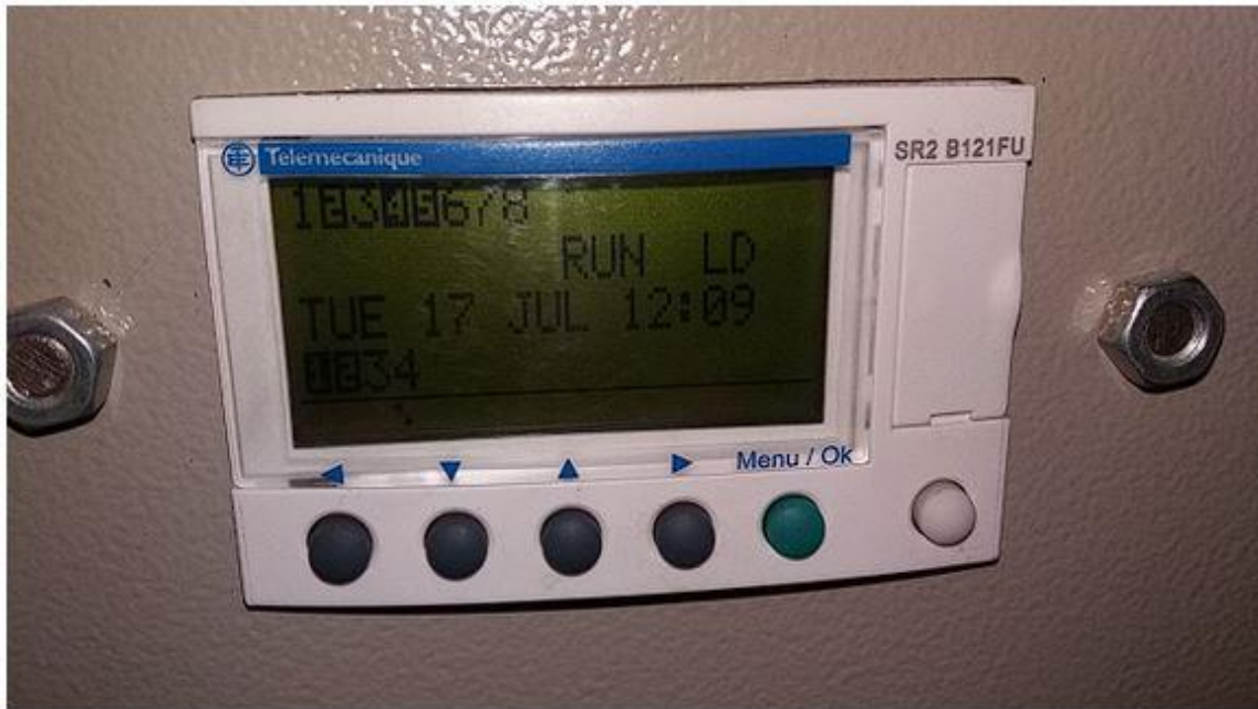
Εικόνα 4.2: Παλιό Κύκλωμα Ελέγχου Λαμπτήρων – PLC Telemecanique SR2-B121U.
