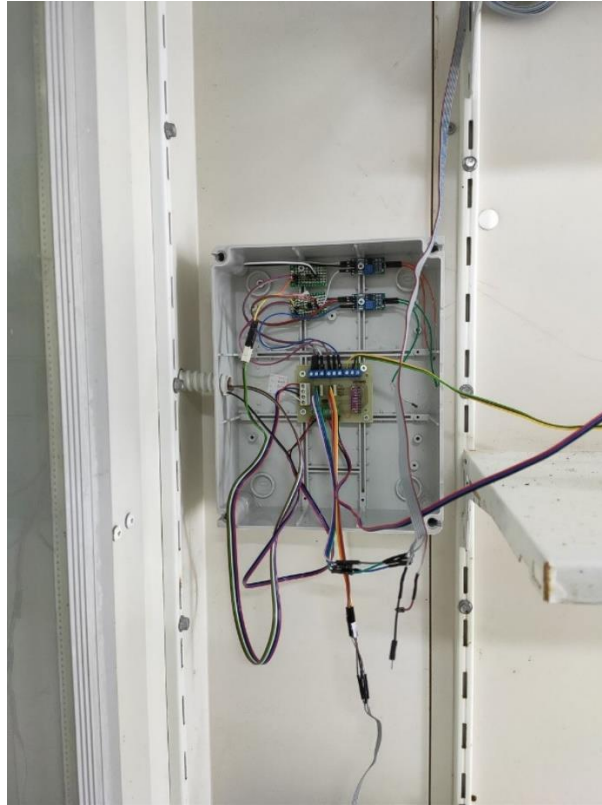
Εικόνα 4.17: Τοποθέτηση κουτιού πλακέτας ADS1015 μέσα στον θάλαμο.
